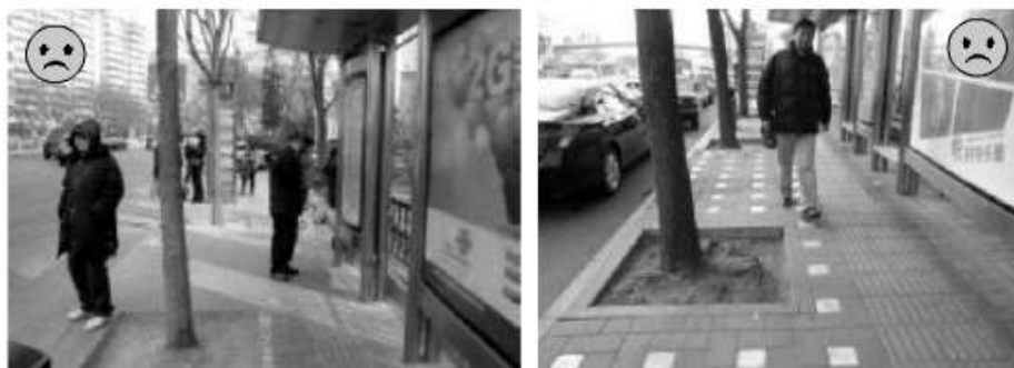
图 7-8 公交车站处未经处理的树池
