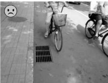
图 10-9 危险的雨水井算子
