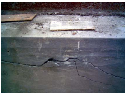
图1 地铁光照门站道床开裂破坏
