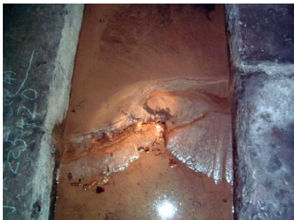
图2 建国门站区间K224+95处轨道地基层冒砂
